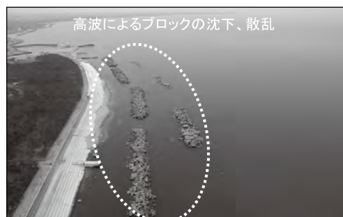
離岸堤の被災状況(平成20年2月)
