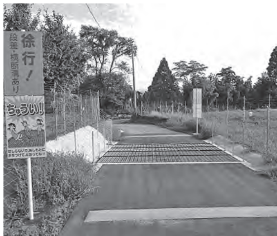
市道に設置したテキサスゲートグレーチング
