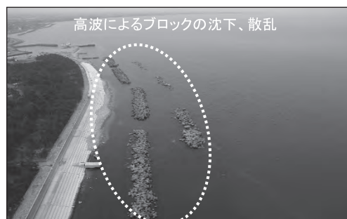
離岸堤の被災状況(平成20年2月)
