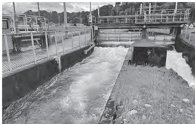
小水力発電の取水口
