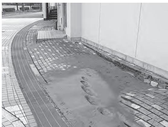
公園内の液状化被害
