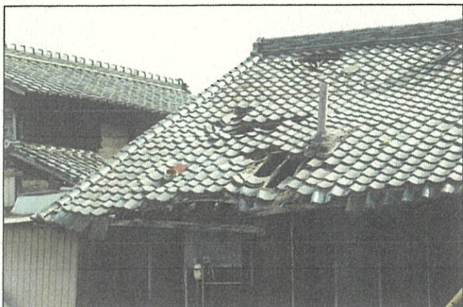
【屋根に穴が開いている】
