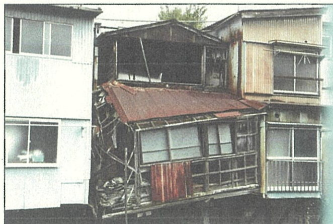
【建物が一部崩壊している】
