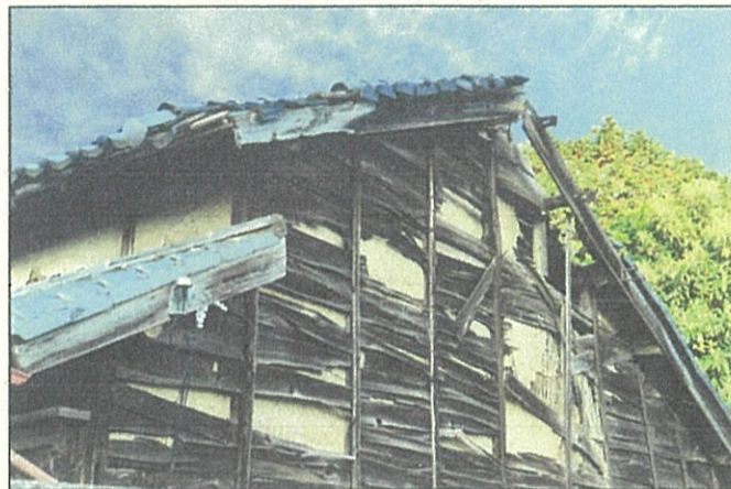
【外壁に貫通した穴がある】
