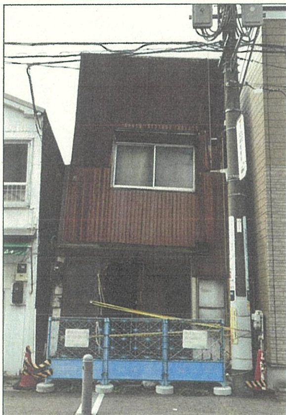
【建物が傾いている】
