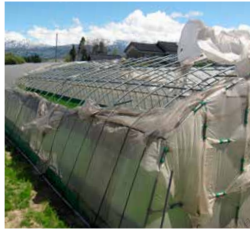
※ 4 月 17 日の暴風で壊れた ビニールハウス＝滑川市内
