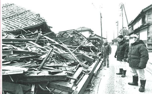
石川県志賀町の被災地調査 赤旗より
