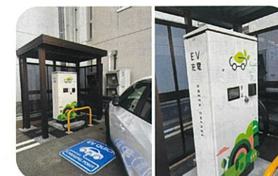
市役所駐車場に電気自動車用急速充電器が配備されました。
