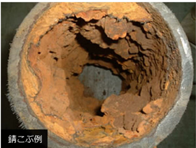
図：水道管内面における錆こぶ
