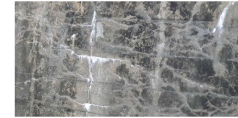
コンクリート橋のひび割れ
